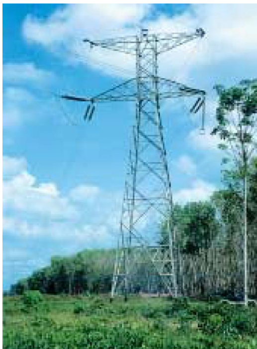
Figura 2.46: Línia de transport HVDC entre Tailàndia i Malàisia.
