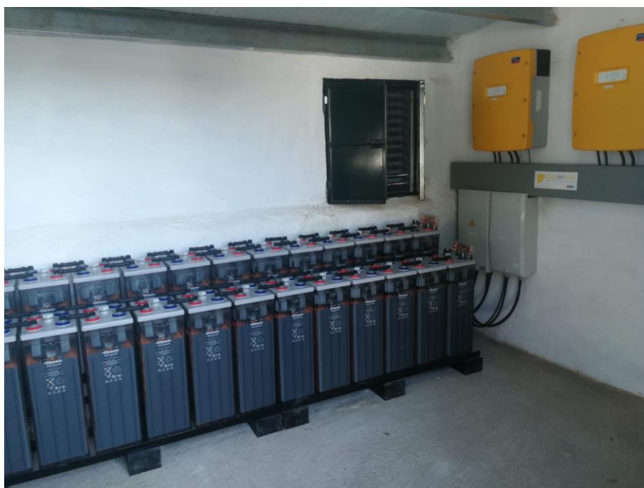
Figura 13: Conjunto de baterías de una instalación fotovoltaica. Fuente: solardelvalle.es
