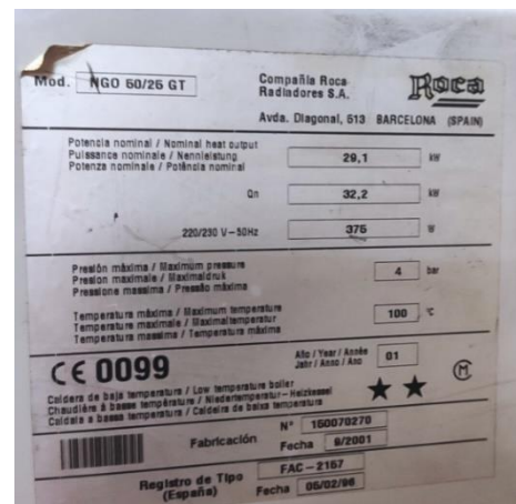
il·lustració 22: Característiques caldera de gasoil actual
