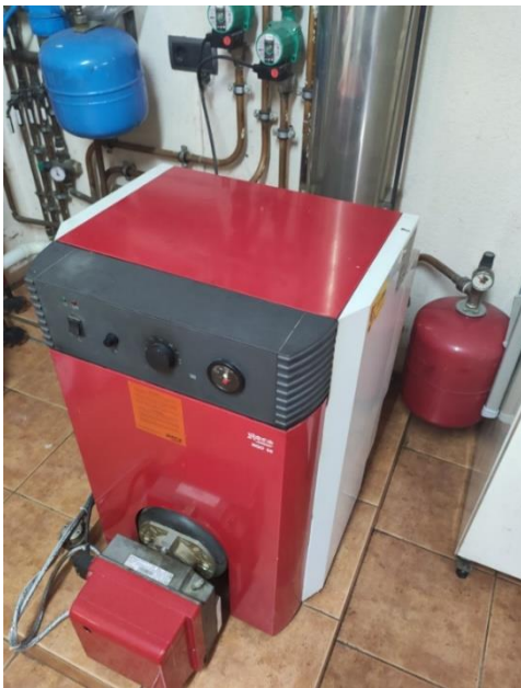
il·lustració 21: Caldera de gasoil actual
