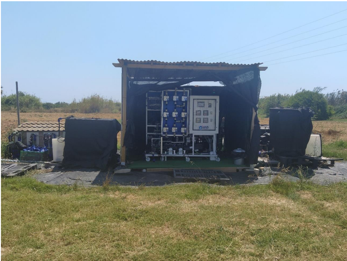
Figura 1-1. Planta de osmosis directa, situada en la parcela. Fuente: IDAEA- CSIC.
