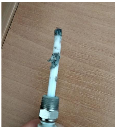
Figura 20: Exemple de tub PTFE trencat
