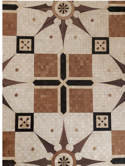
Fig. 40: Acabados en madera del suelo de una de las estancias del Palacio de Invierno
