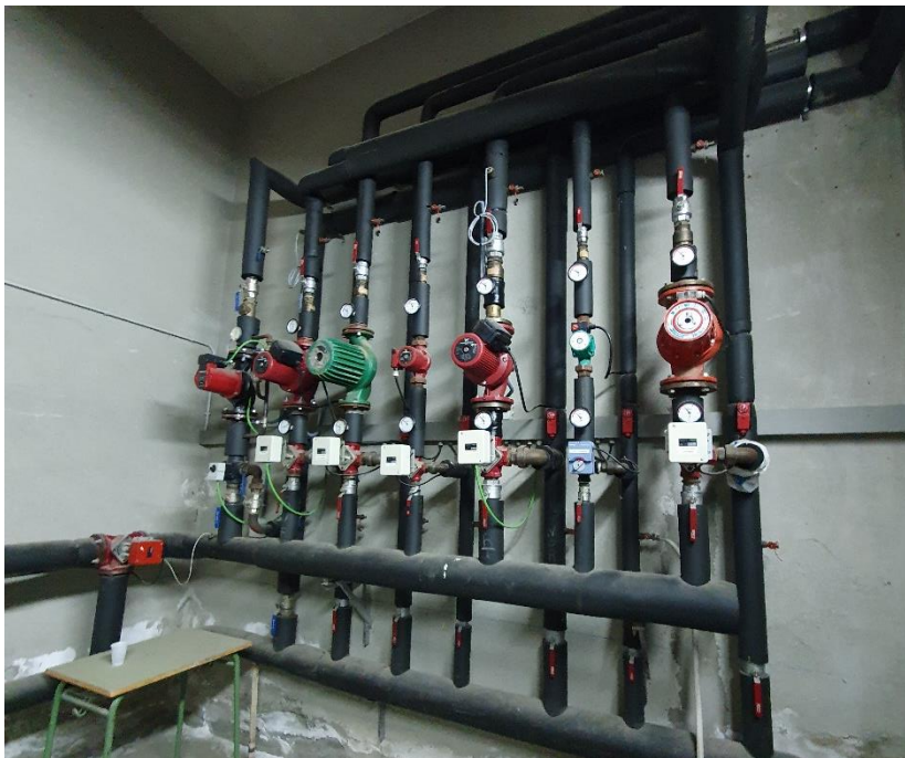
Figura 42. Col·lector i sis circuits de la instal·lació (font pròpia).
