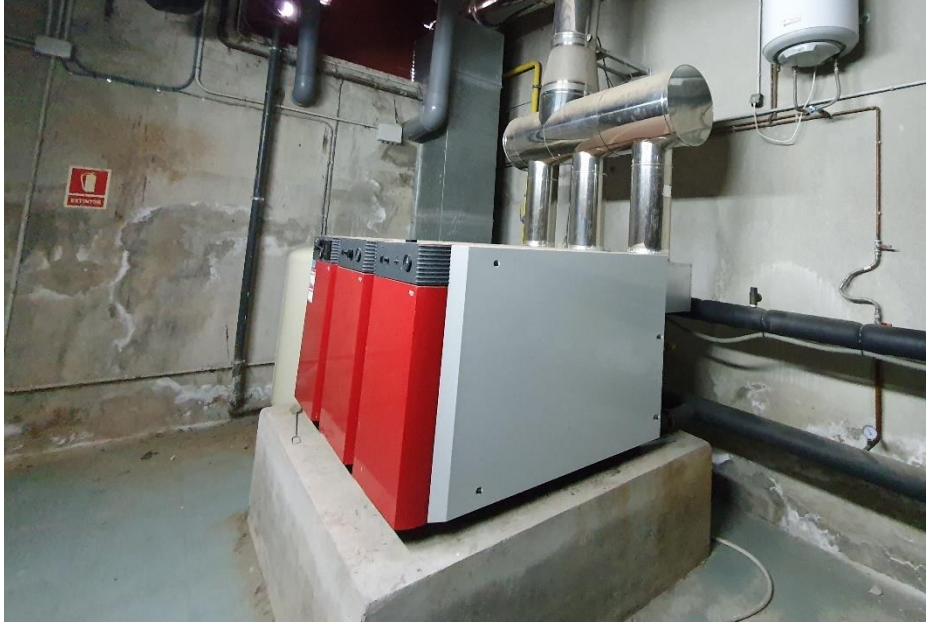
Figura 41. Calderes de gas natural (font pròpia).
