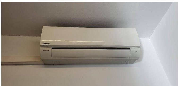
Figura 45. Equip d'aire condicionat petit (consergeria, secretaria i direcció) (font pròpia).
