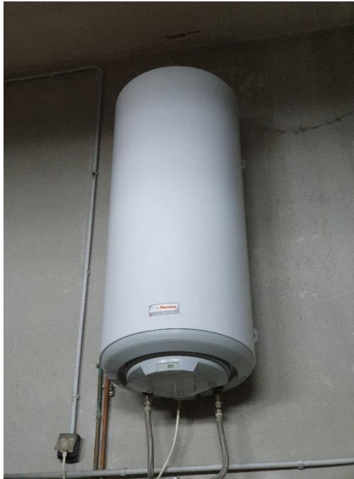
Figura 43. Acumulador ACS cuina i cafeteria (font pròpia).
