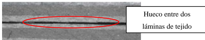
Figura 14. Defecto por delaminación. Extraído de [29].
