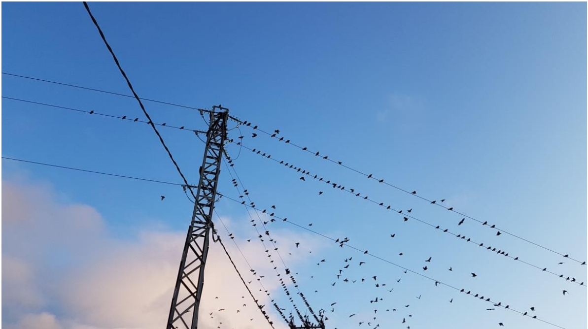
Foto 1. Estornells en una línia de mitjana tensió de 25 kV. Font pròpia.
