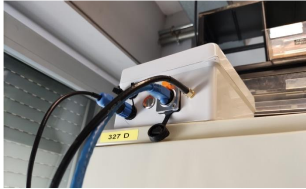
Fig. 4.20: Estación de tierra con todas las conexiones realizadas, encendida y lista para funcionar.
