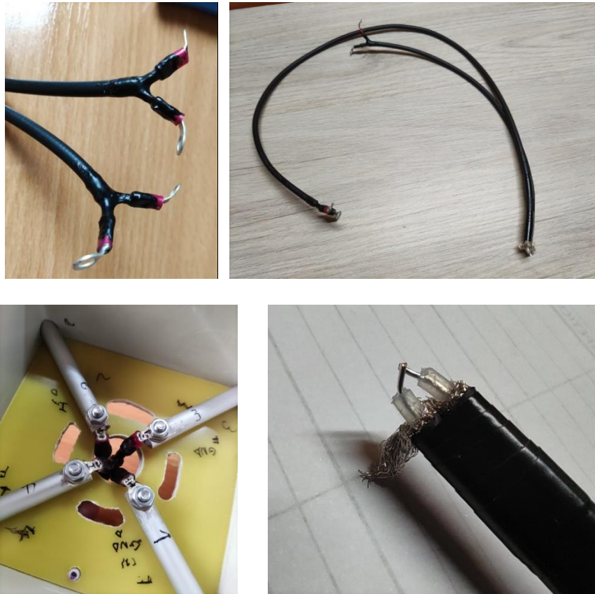
Fig. 3.17: Cableado fasado y terminales.
