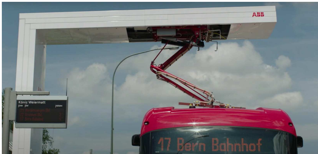
Fig. 3 Estació de càrrega autobús elèctric pantògraf avall. (ABB, s.d.)
