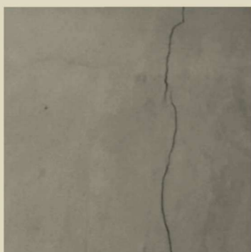
Fissura interior a la mitgera
