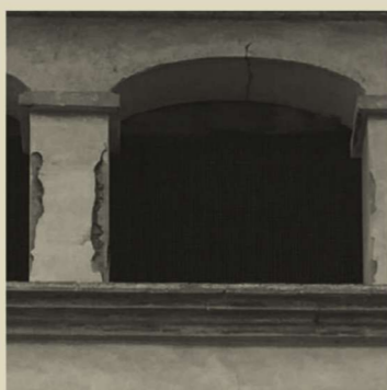
Desprendiments i esquerda a la façana
