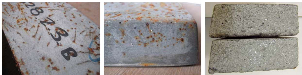
Figura 4. Presencia del óxido de las fibras superficiales. Muestra cortada.
