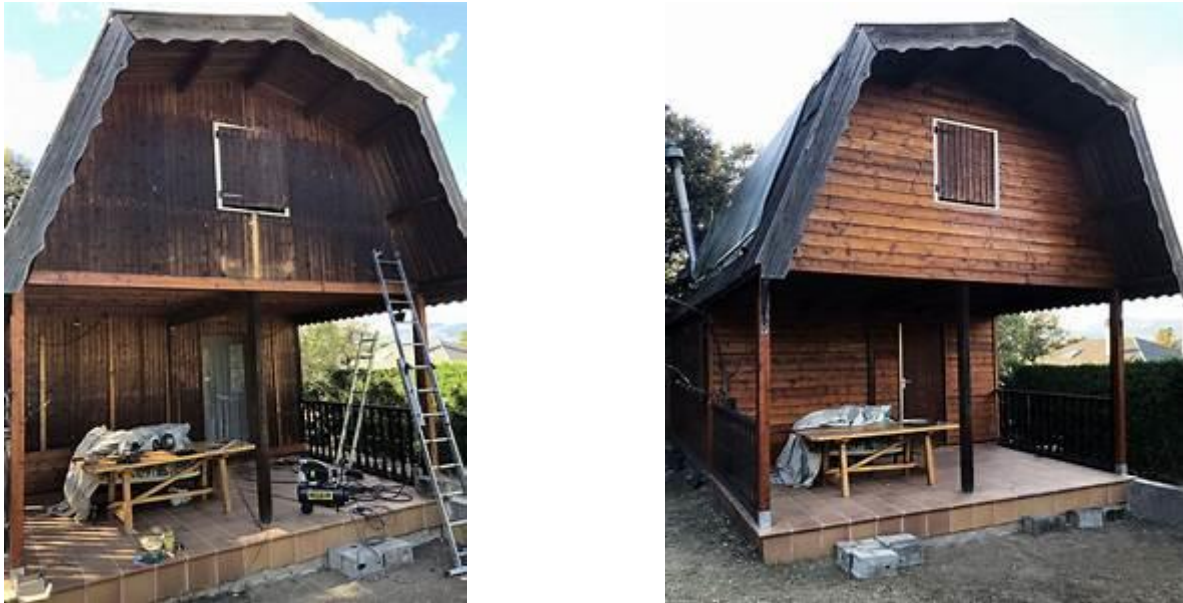
Figura 2.1 Degradación del color de la madera de pino de la fachada y sustitución por nuevas lamas de pino Fuente: https://www.mcmcasas.com/project/fachada-madera-2/
