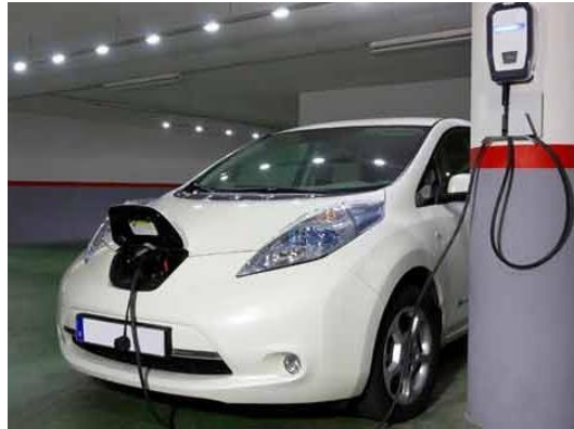
Figura 12.1 Exemple d'un punt de recàrrega en un garatge comunitari. [46]
