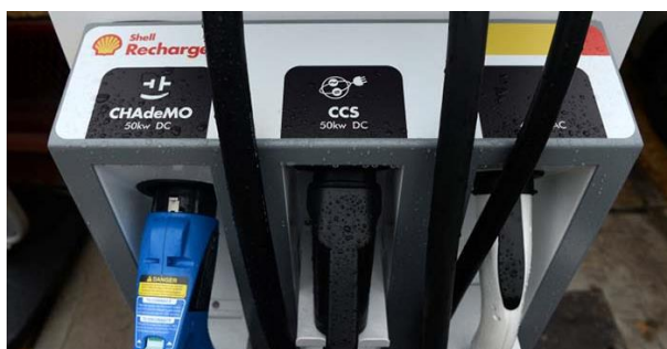
Figura 7.8 Exemple de punt de recàrrega ràpida amb connectors CCS, CHAdeMO i Mennekes. [21]
