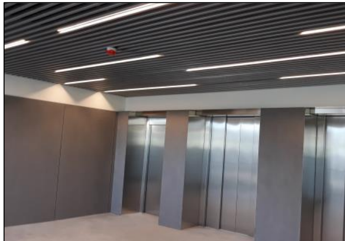
Fotografía A.11: Ascensores del Bio-Edificio Gonsi Sócrates (Construcía and Eco Intelligent Growth, 2020)
