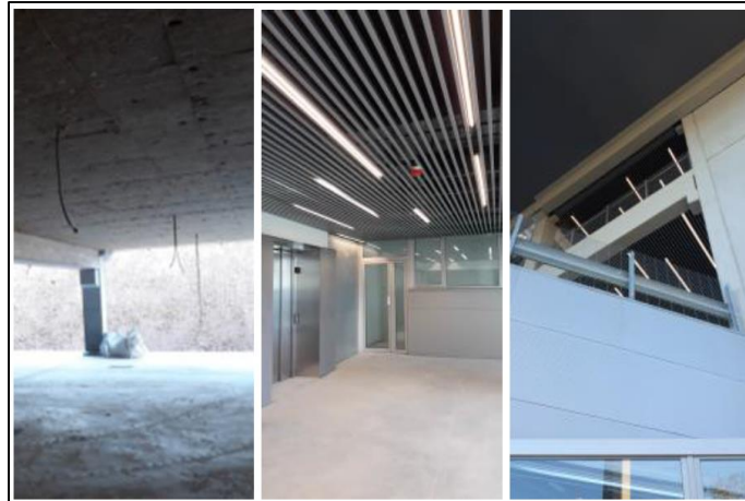
Fotografía A.4: Techo del Bio-Edificio Gonsi Sócrates (Construcúa and Eco Intelligent Growth, 2020)
