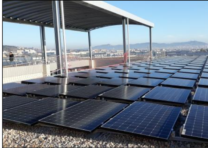
Fotografía A.10 Paneles fotovoltaicos del Bio-Edificio Gonsi Sócrates (Construcía and Eco Intelligent Growth, 2020)
