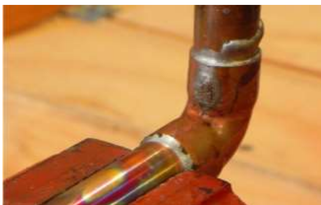
Imatge 28: Canonada de coure en concret de la seva soldadura
