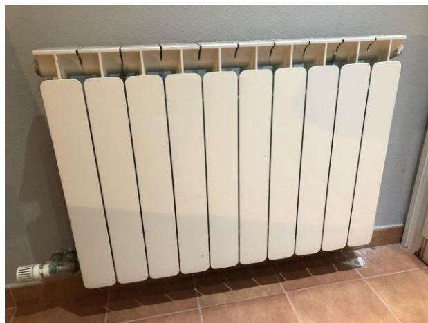
Figura 2.4. Radiador (Autora: Aina Bergadà)
