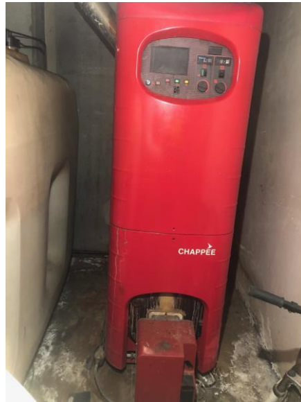
Figura 2.3. Caldera de gasoil de 15 kW (Autora: Aina Bergadà)
