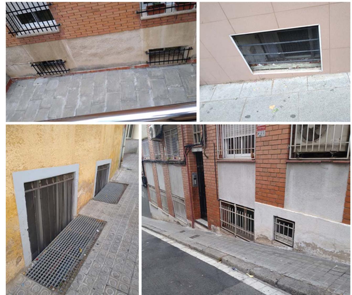
Ventilació d'habitatge a través de finestres de soterrani o semisoterrani que donen a carrer
