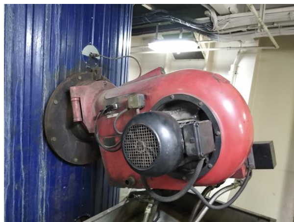
Figura 24: Motor eléctrico y ventilador de una caldera. Fuente propia.
