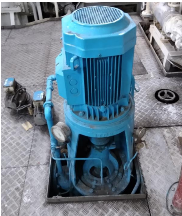
Figura 46: Bomba centrífuga de sentinas de emergencia. Fuente propia.
