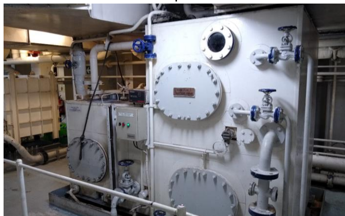
Figura 18: Tanque de recogida de condensado. Fuente propia.
