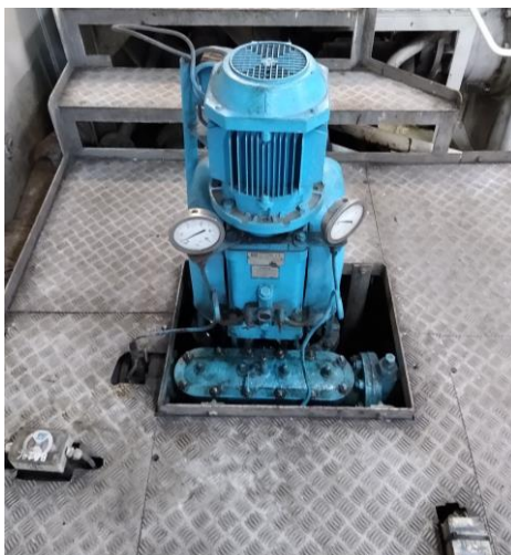
Figura 43: Bomba alternativa de sentinas con los actuadores de sus válvulas de aspiración (derecha) y descarga (izquierda). Fuente propia.
