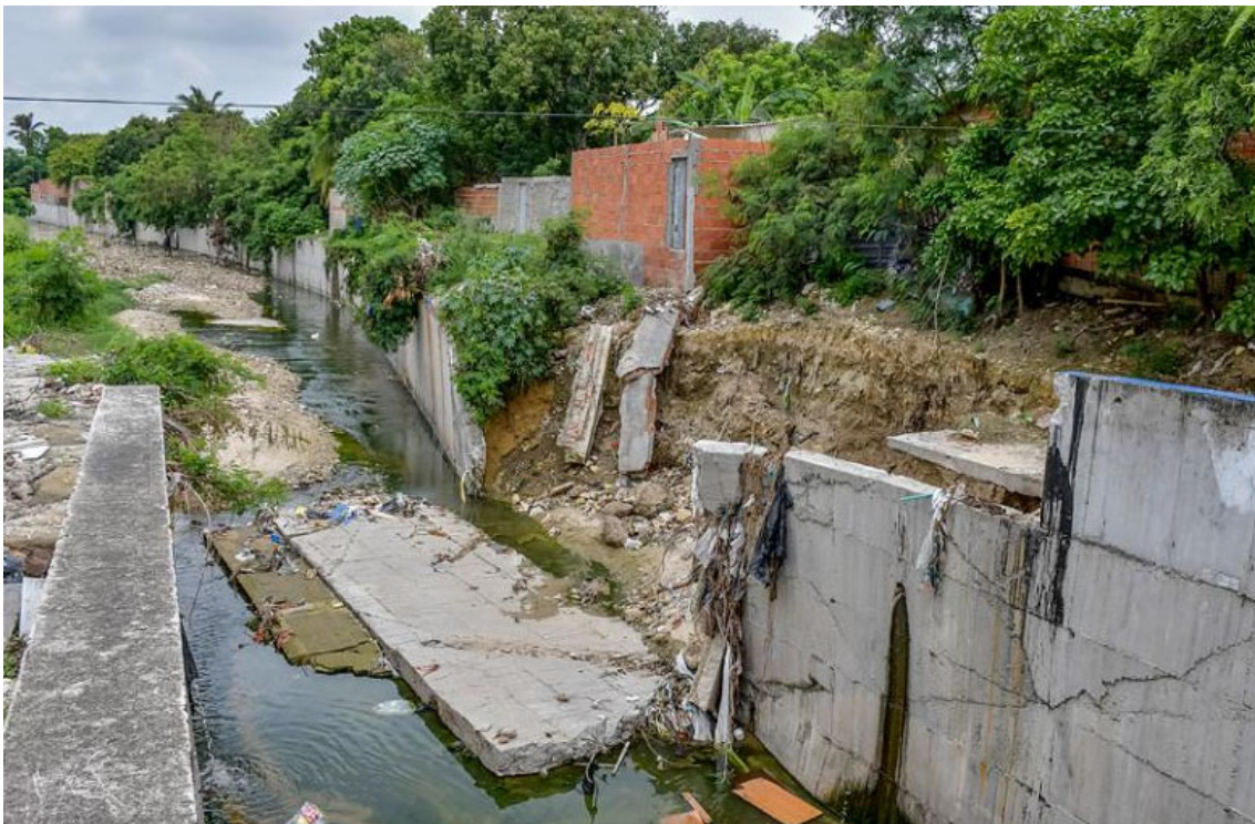
Figura 3.5. Caída del muro de protección del arroyo Don Juan en Colombia, (Narváez, 2018).
