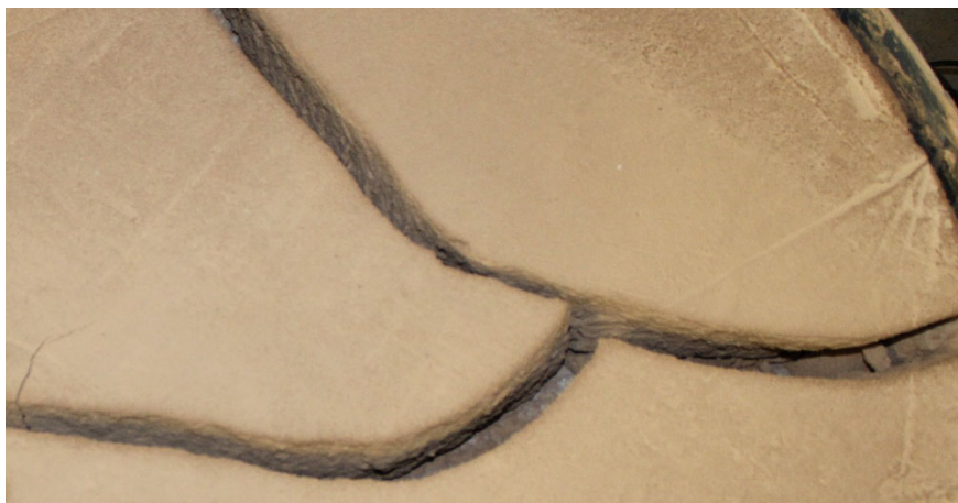
Figura 5.42. Profundidad de las fisuras en la capa superior.
