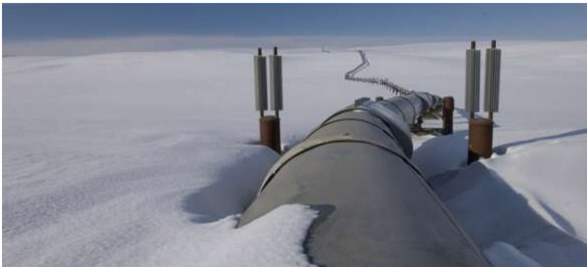
Figura 30. Oleoducto de la terminal Naryanmarneftegaz. Fuente: https://www.neftegaz-online.com/
