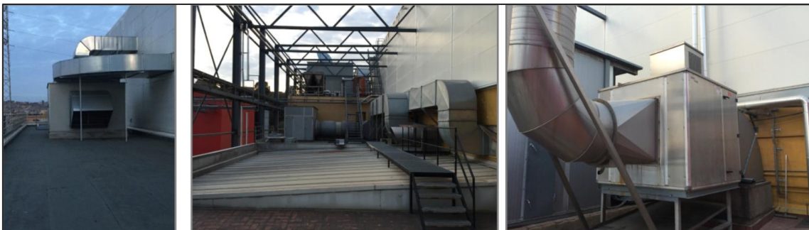
Figura 41: Unidades de impulsión y extracción de aire zona de producción.
