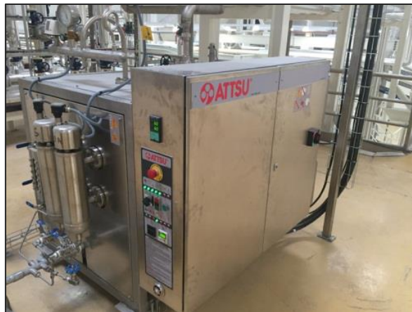
Figura 39: Caldera eléctrica de vapor.
