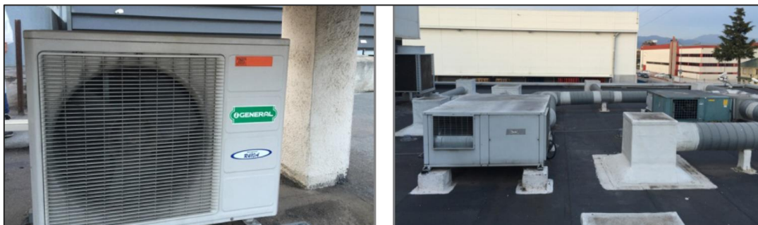
Figura 43: Splits oficinas y servidores.
