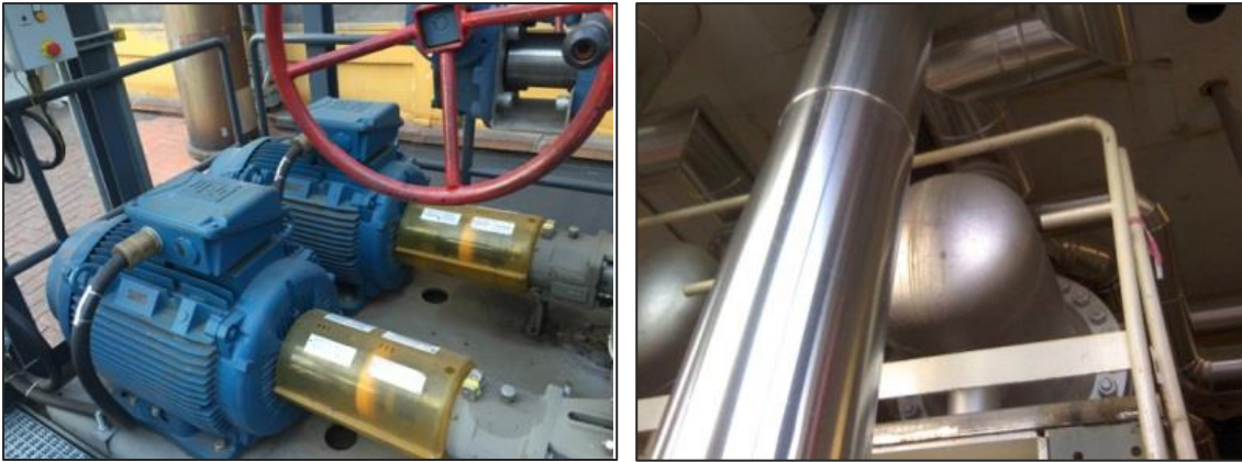
Figura 34: Bombas de agua caliente (izquierda) e intercambiador de calor (derecha).
