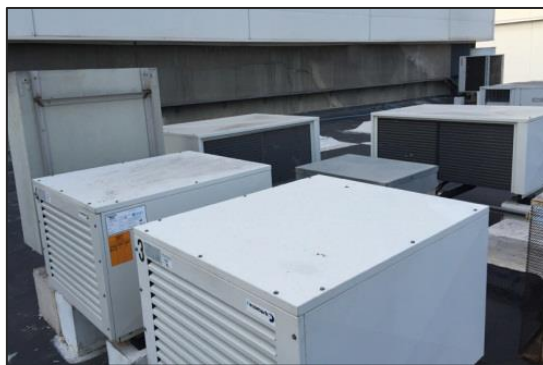
Figura 46: Equipos de frío cámaras frigoríficas.
