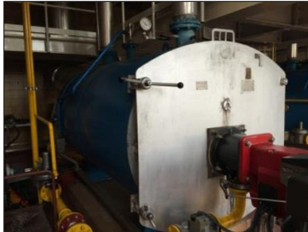
Figura 36: Caldera de agua sobrecalentada.
