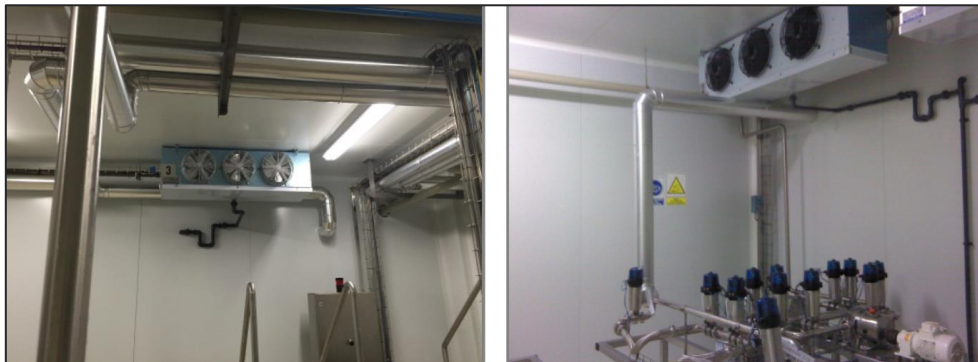
Figura 45: Cámaras frigoríficas de huevo (izquierda) y válvulas de distribución (derecha).
