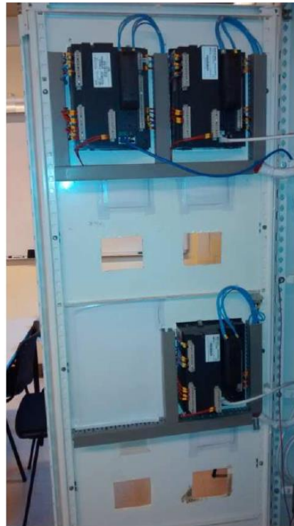
Figura 32: Cableado de los SEPAMS
