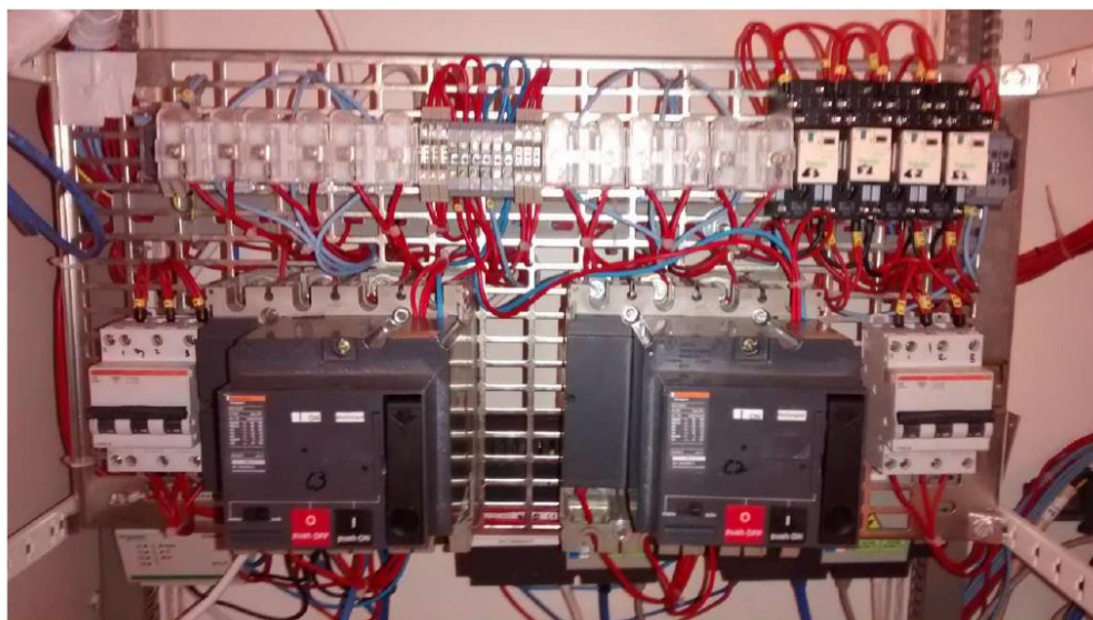
Figura 34: Cableado por dentro del armario
