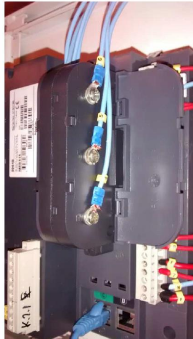
Figura 33: Conexiones sin terminales
