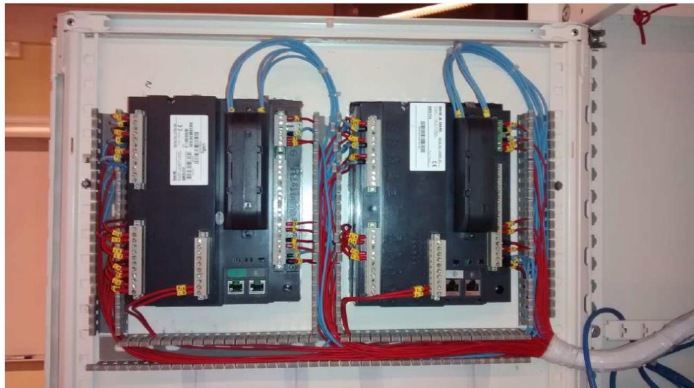
Figura 36: Cableado de los SEPAMS
