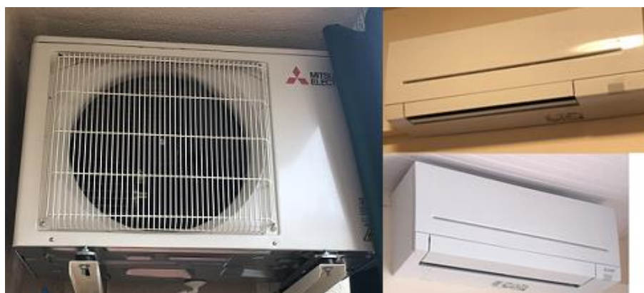
Fig 4.6. Unitat exterior i interiors de la bomba de calor.
