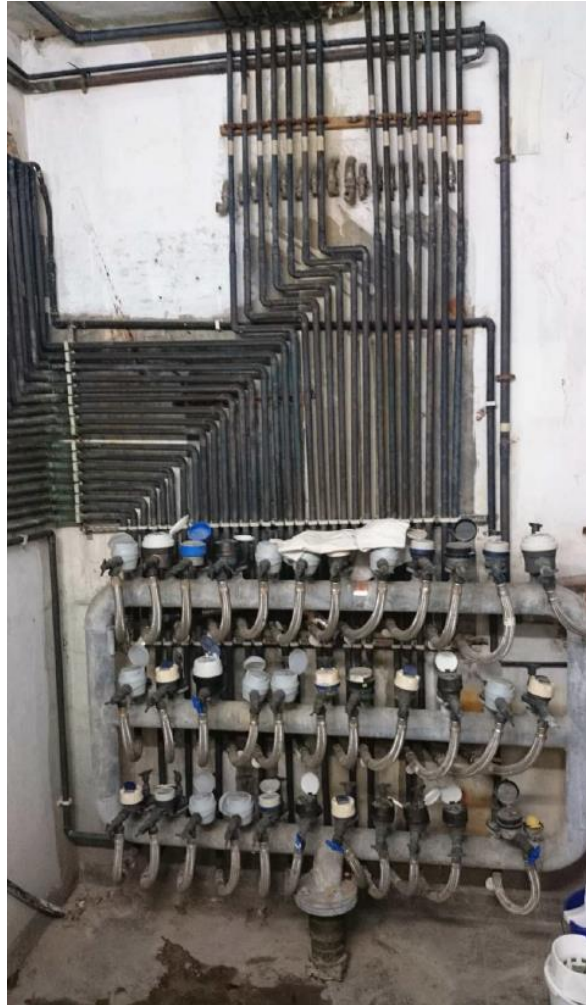
Fig 3.26. Bateria de comptadors de la instal·lació d'aigua [13].
