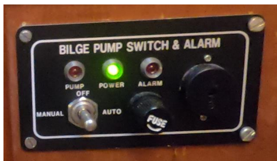
Figura 94. Panel de control de la bomba de achique
