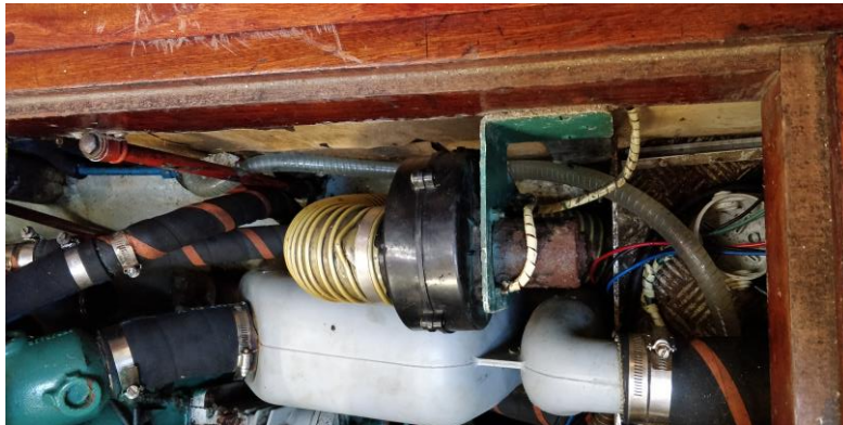
Figura 21. Tubo del sistema de ventilación del motor
