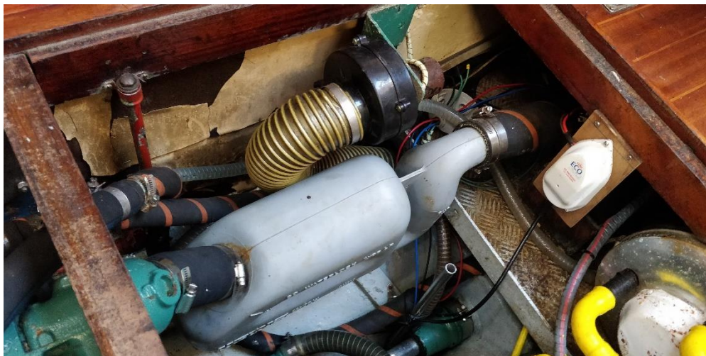
Figura 93. Bomba de achique
