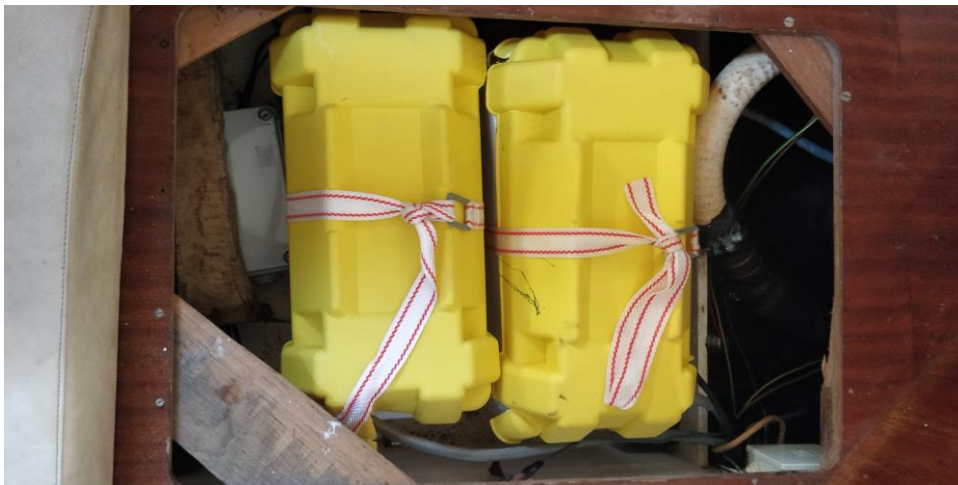
Figura 32. Baterías de 12 V conectadas en paralelo
