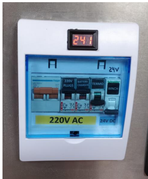
Figura 30. Cuadro eléctrico general del barco
