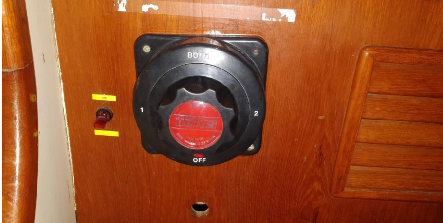
Figura 33. Desconectador baterías del servicio de 12 V
