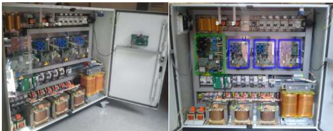
Figura 7. Montaje final de la microrred implementada
