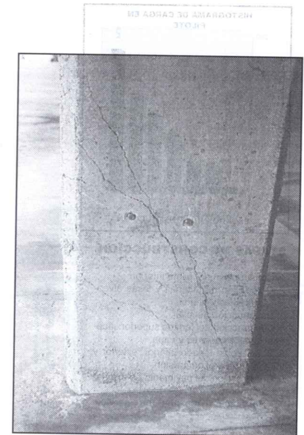
Figura 2 - Fisuras diagonales en pilares cortos.
