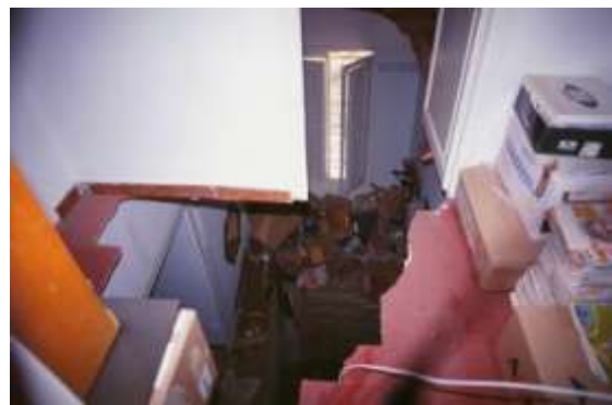
Fig. 10 Hundimiento de la bóveda y tabique "trabajando" a tracción
