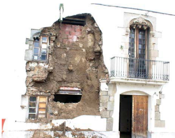
Figura 10 Colapso de fachada de tapial y formación de arco de descarga "reequilibrante"
