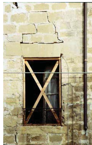
Figura 11 Formación de arco de descarga por asiento y rotura de dintel
