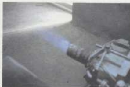
Detalle de la llama en el quemador, con biogás
