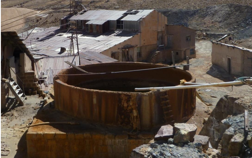
Fig. 5.1 Depósito donde se almacenaría el agua bombeada.
