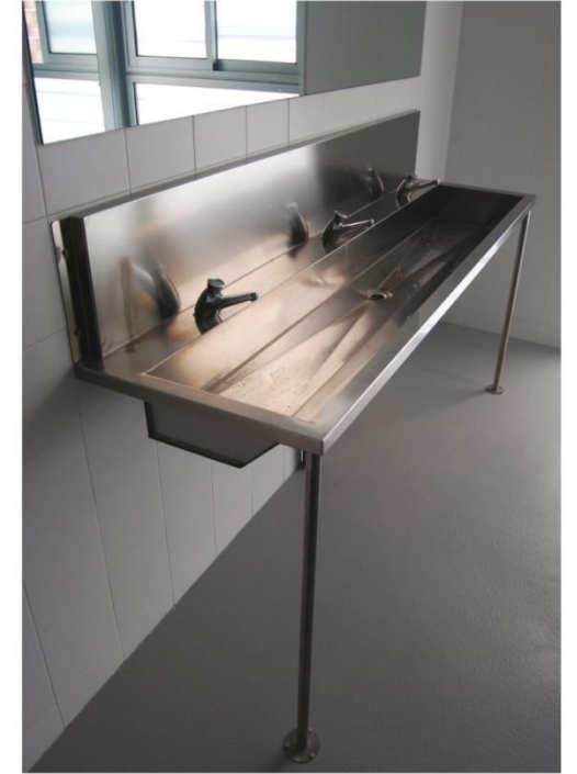
SANITARIOS_elemento único de acero inox
