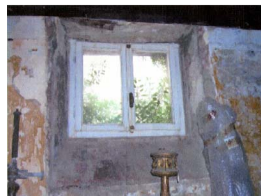
Planta egona: Humitat grau 3 - termites - esquerdes estructurals
