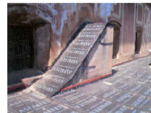
Planta coberta: Paret amb humitat grau 1 - pintura saltada
