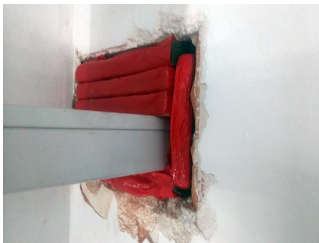
Figura 29: Protecció de safates per sacs intumescents. (Vimat Ignufats SL, n.d.)
