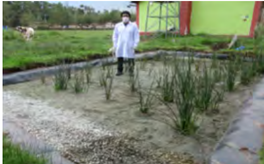
Figura 4a. Humedal construido de tipo subsuperficial horizontal en la I.E. 50106.
