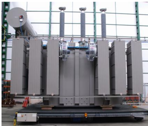
Figura 3.19: Transformador de potencia. Fuente: Imefy.
