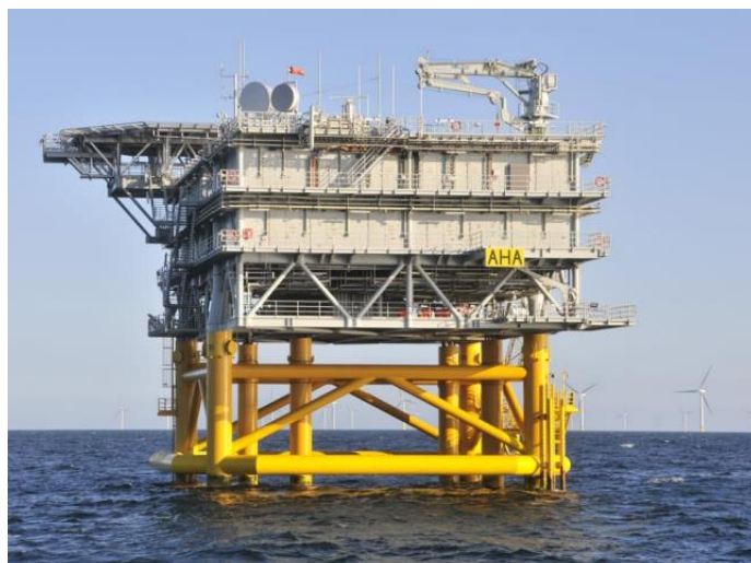
Figura 4.14: Subestación de transformación en el parque eólico off-shore Anholt. Fuente: [21].
