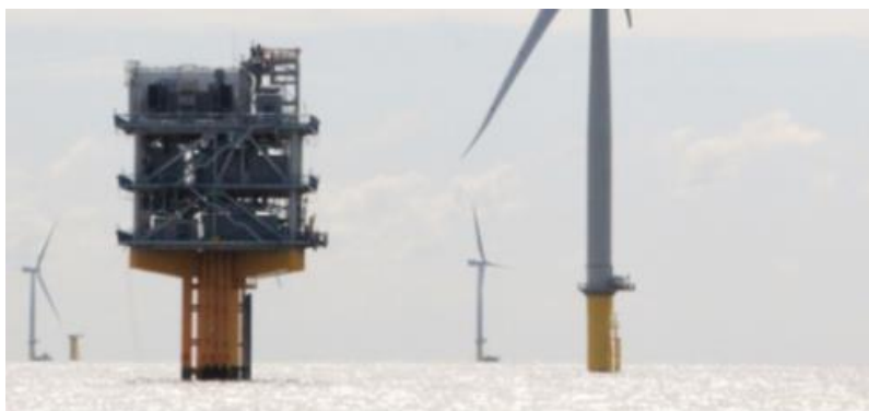
Figura 4.33: Subestación de transformación del parque London Array. Fuente: [43].
