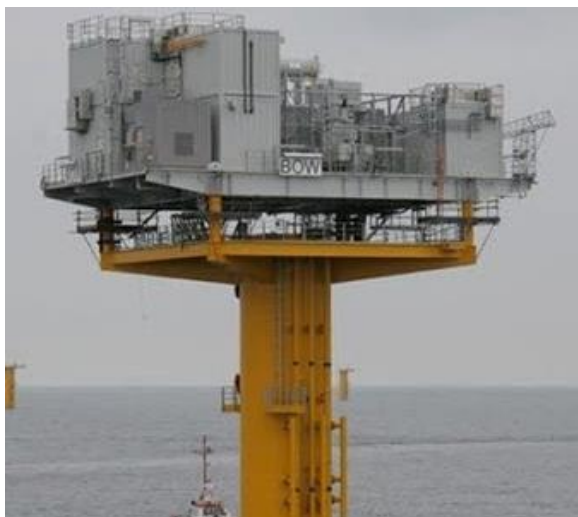
Figura 3.18: Subestación elevadora en el parque eólico Barrow Windpark: Fuente: Ingenieriaelectricaexplicada.
