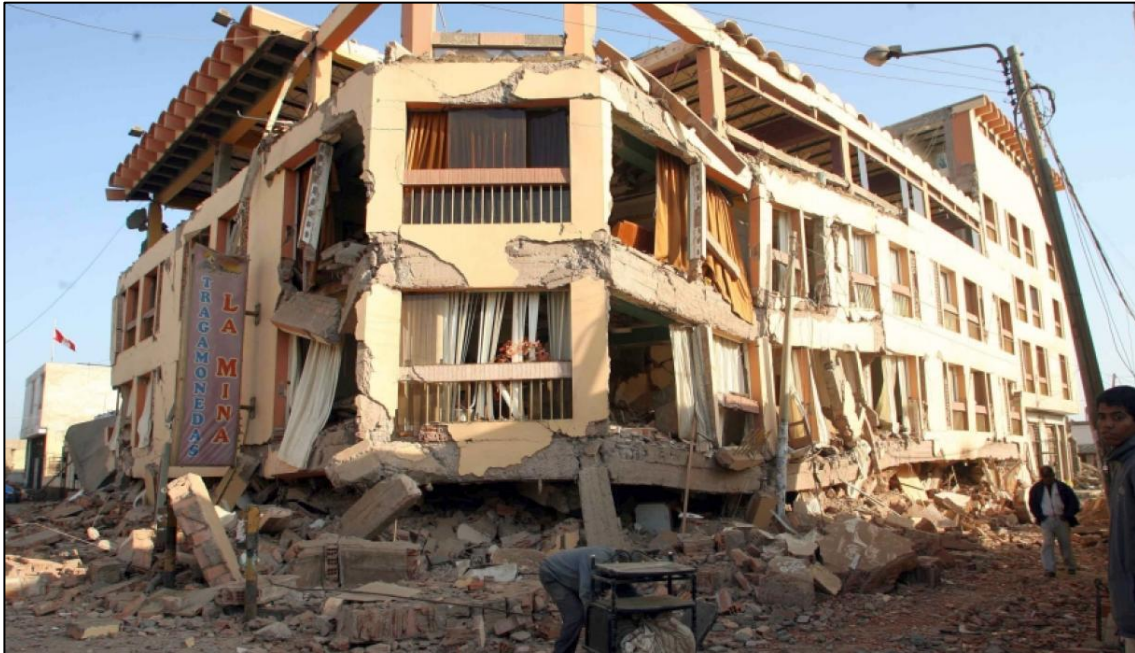
Figura 5. Daños terremoto Pisco 2007
