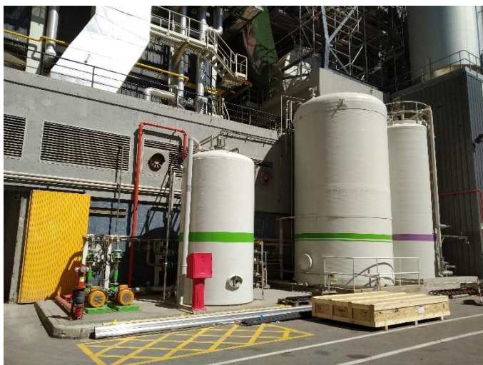
Figura 17. Actual ubicació del tanc d'urea (el de la dreta), on se situarà el tanc de \text{NH}_3 del SCR.
