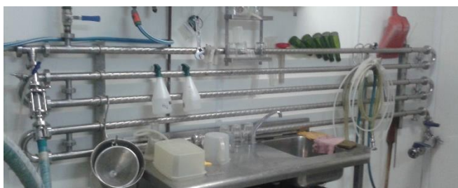
Figura 9. Bescanviador de calor a contracorrent per refredar el most. Font pròpia
