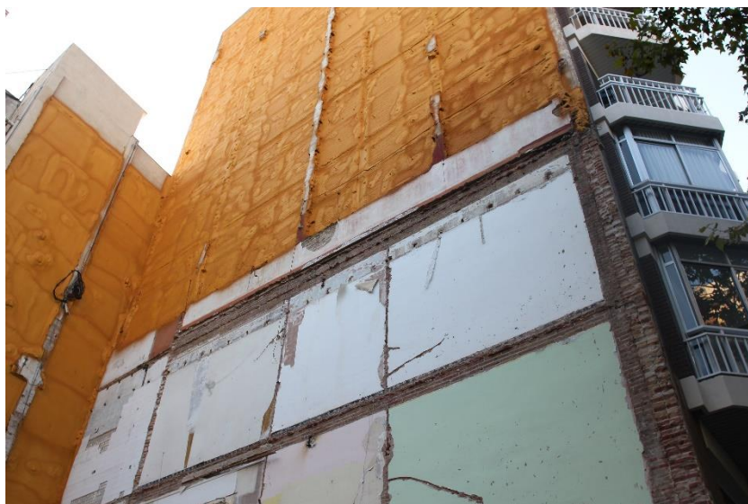
Figura 14: Vista de l'enderroc d'un edifici tipus xamfrà per a la construcció d'una altre promoció d'habitatges 2
