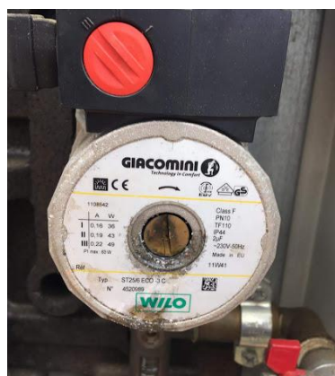
Figura 3.11. Bomba del circuit primari [font pròpia]
