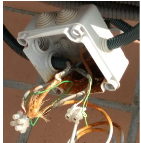
Figura 4.10. Caixa de cables de l'acumulador [font pròpia]
