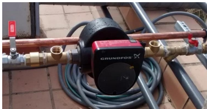
Figura 3.15. Bomba del circuit secundari [font pròpia]
