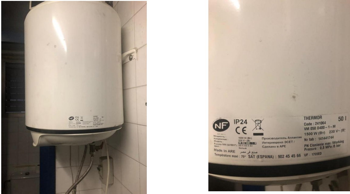
Figura 20: Fotografies del termo elèctric calentador d'ACS
