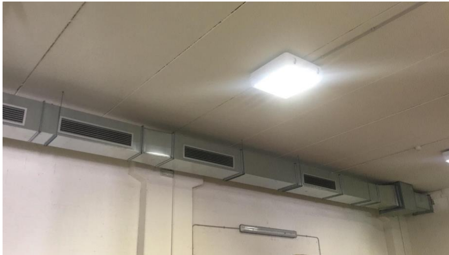
Figura 25: Ventilador centrífug en la paret del taller de vehicles en la planta semisoterrània
