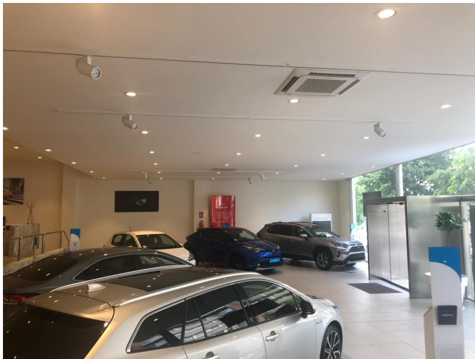
Figura 22: Bomba de calor tipus Cassette (al sostre de la planta)
