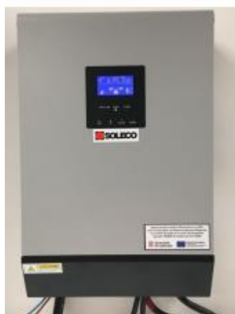
Figura 3.14. Inversor MKS 5K Axpert. Fotografia de l'autor
