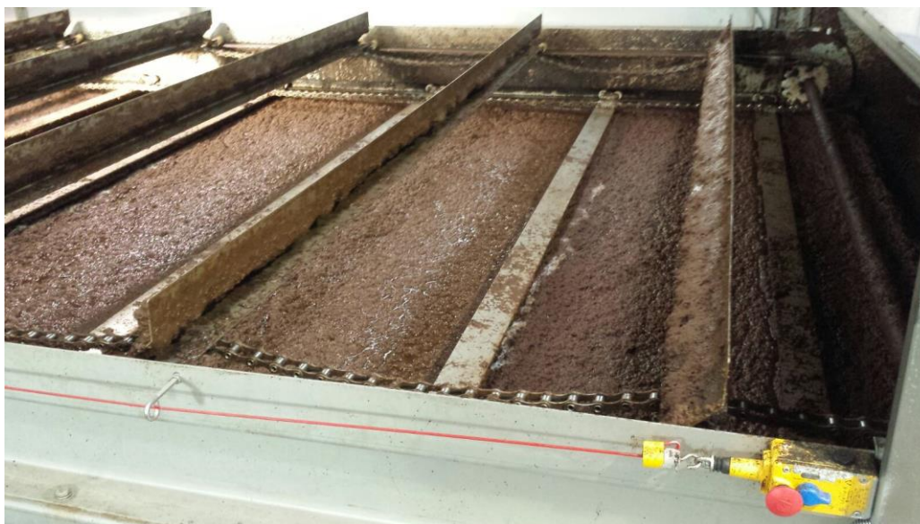
Figura 1 Sistema de flotación por aire disuelto (DAF) de fangos secundarios
