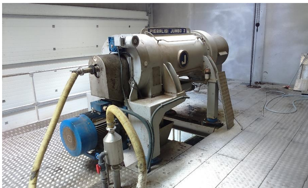
Figura 2 Centrífuga para la deshidratación de los fangos
