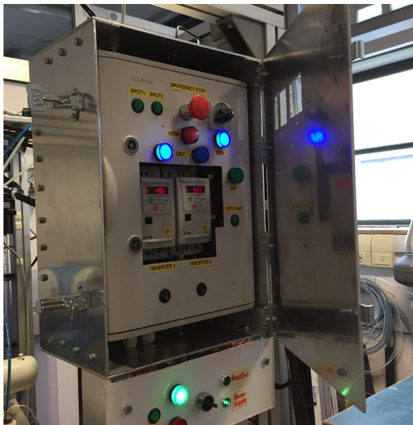
Figura 3-16. Schermo installato per ridurre l'effetto dei disturbi generati negli inverter
