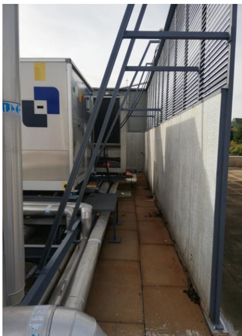
Fotografía 3.16 Maquina exterior de climatizado
