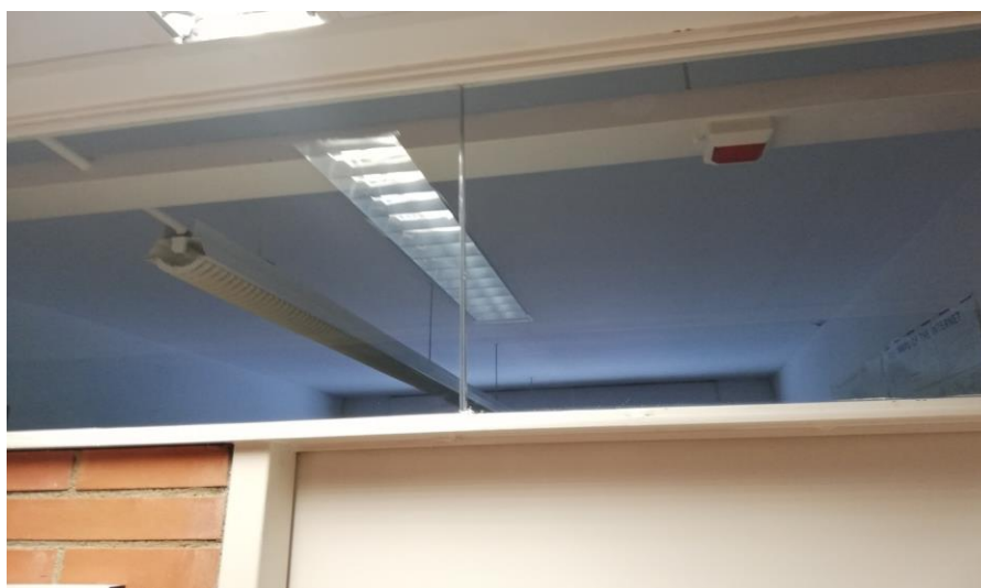
Fotografía 3.13 Luminaria existe en aulas
