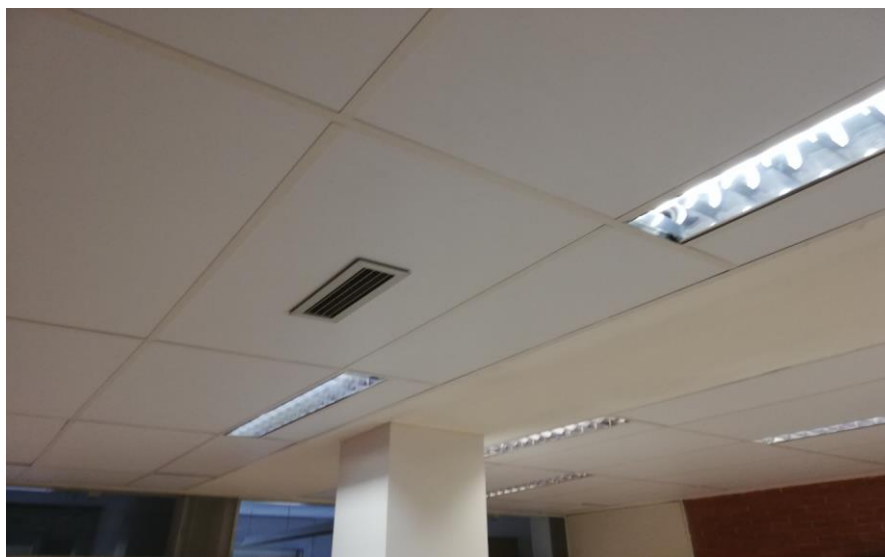
Fotografía 3.12 Luminaria existe en zonas comunes
