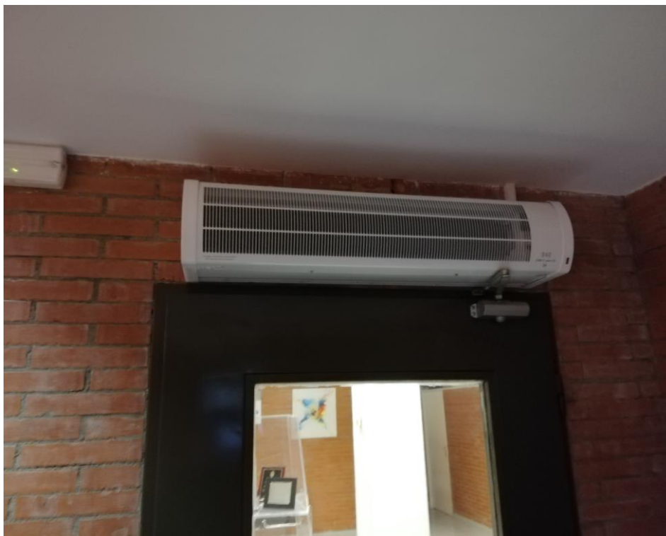
Fotografía 3.15 Maquina interior de climatizado
