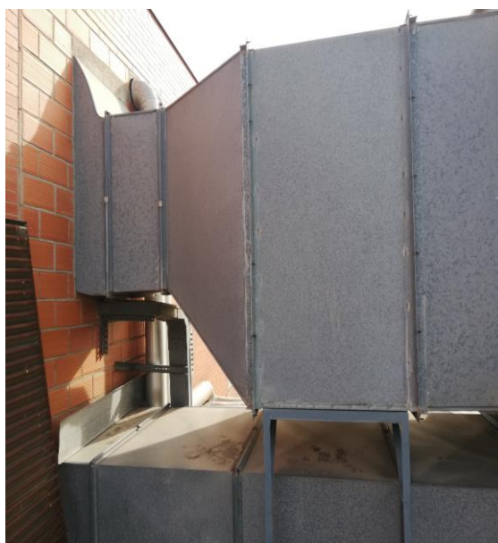
Fotografía 3.17 Maquina exterior de climatizado, tobera
