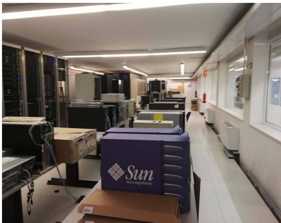
Fotografía 3.14 Sala de Servidores
