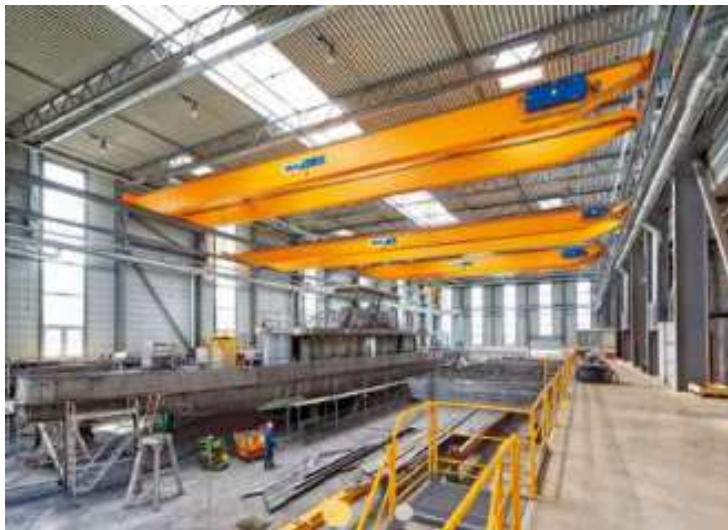
Imagen 33: Ejemplo de puente grúa bi-raíl.
