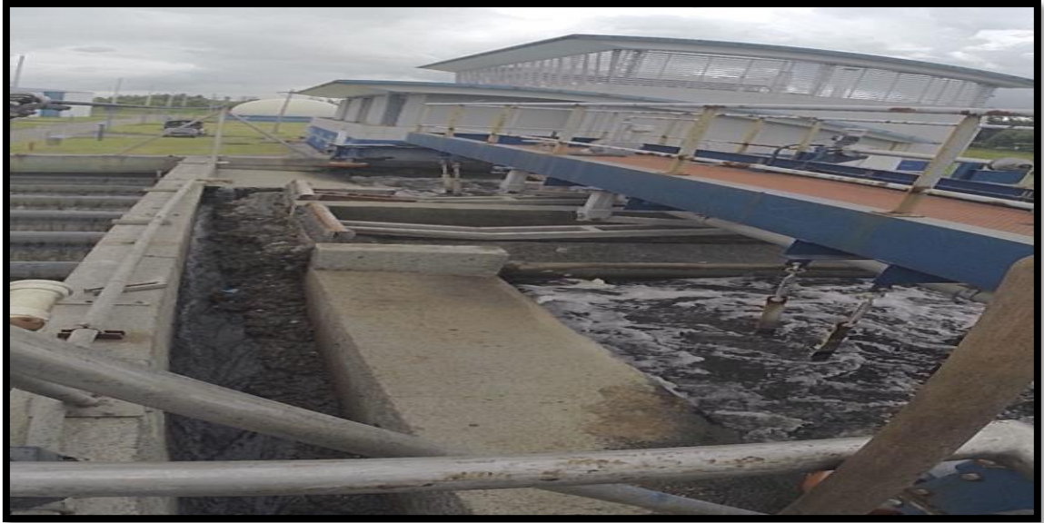
Figura 4.8 Canales para la extracción de grasa y arenas. Fuente: Fotografía de elaboración propia
