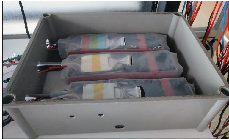
Figura A.3 – Caixa amb les bateries a dins
